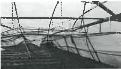
Estufa danificada pelo vento
