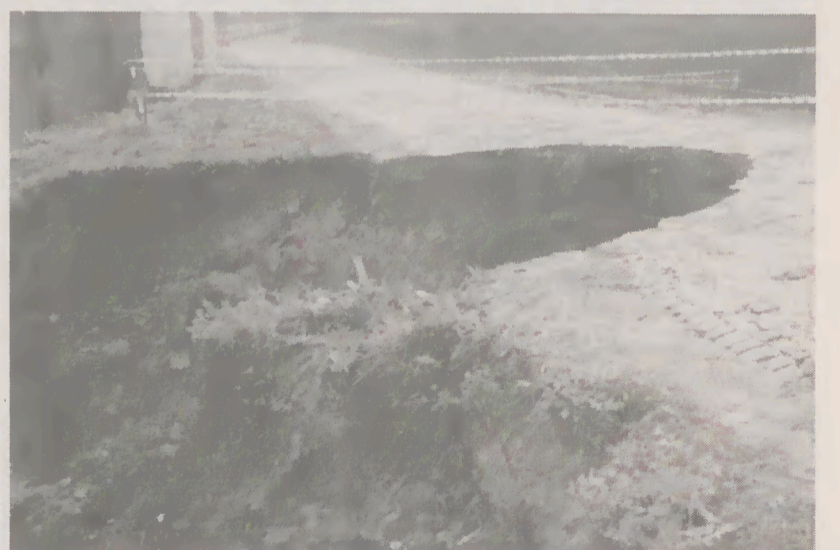
Em Escariz, surgiu este enorme buraco na estrada.
