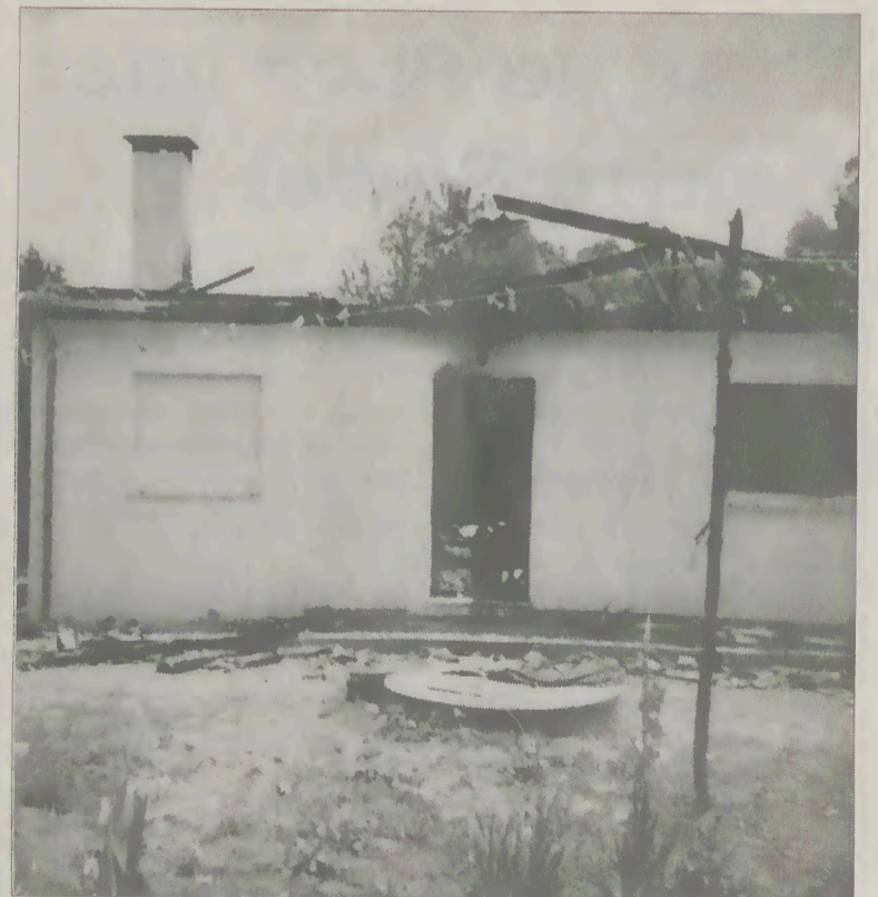
Apenas sobraram as paredes exteriores daquilo que tinha sido uma habitação.
