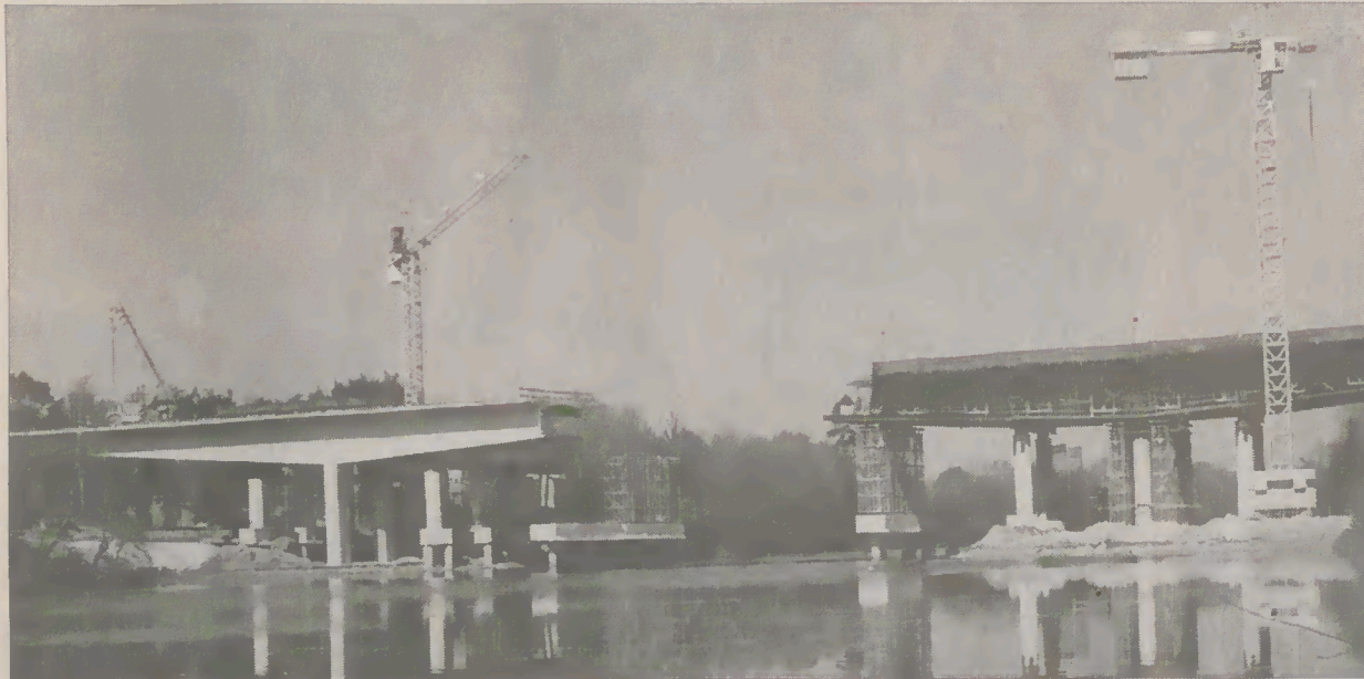
O primeiro tabuleiro da nova ponte sobre o Cávado está em vias de estruturação final.
