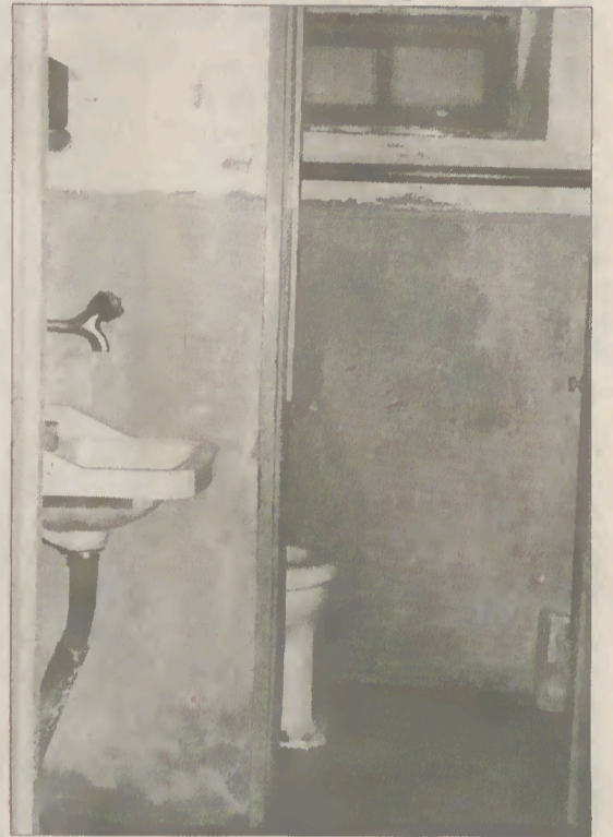
Enquanto se avança pedagogicamente as repugnantes casas de banho mantêm-se.
