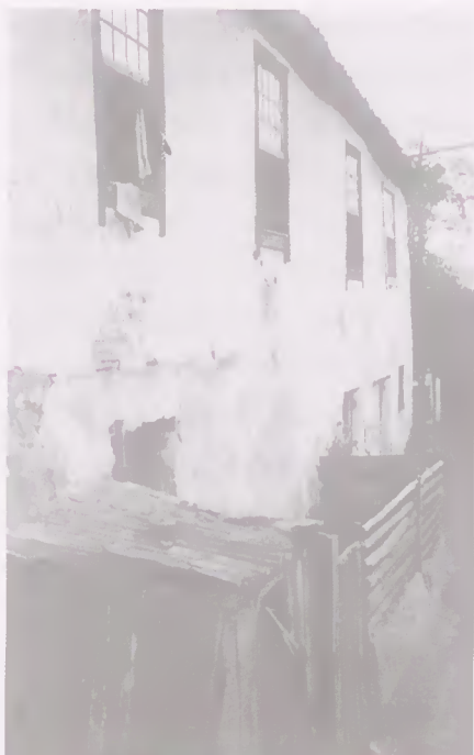
Casa degradada no Rigor
