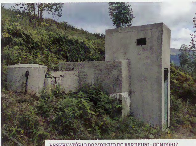
RESERVATÓRIO DO MOINHO DO FERREIRO - GONDORIZ
