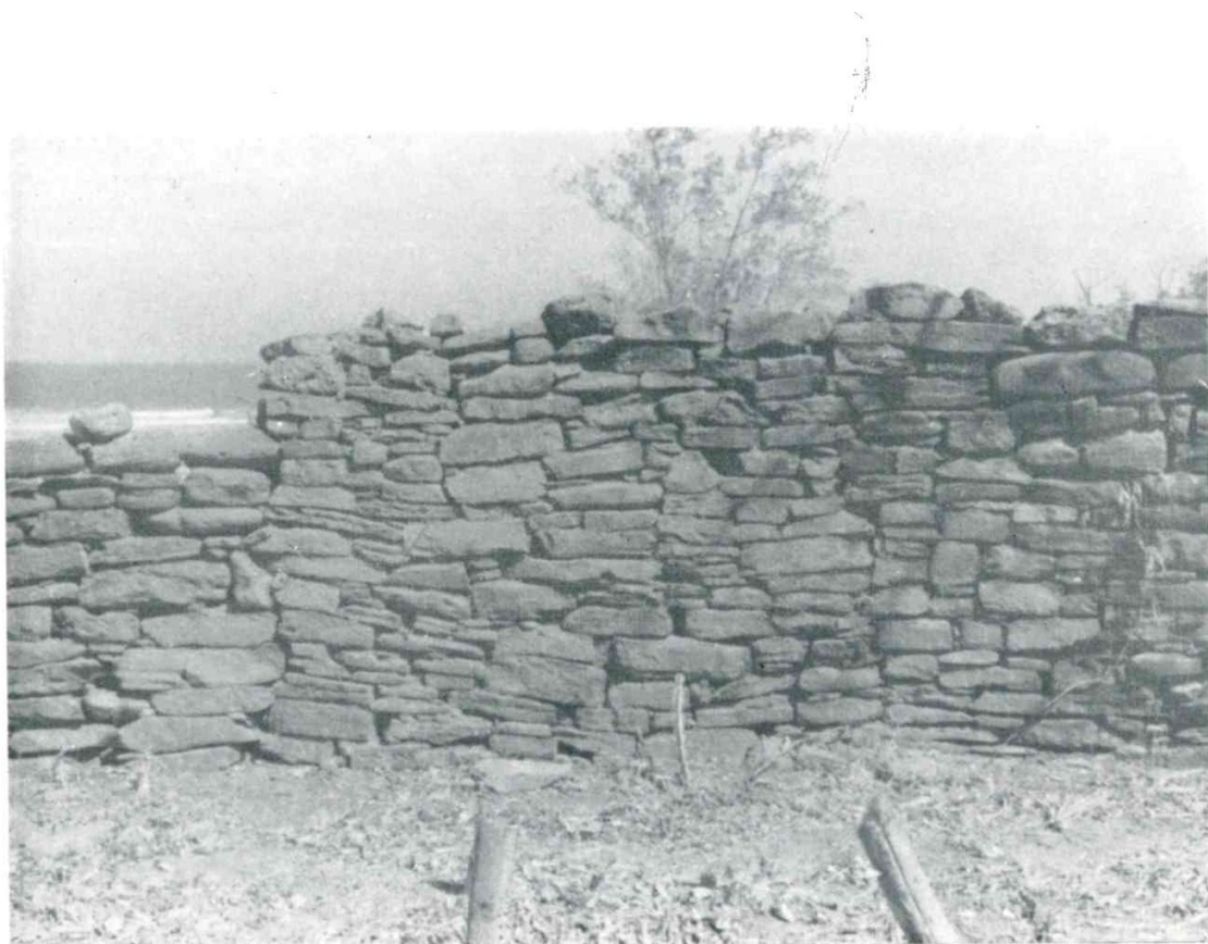
Fig. 5 — Aspecto da muralha do lado sul com cerca de 2 metros de altura
