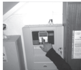
A Central de Incêndio detetou o incêndio alertando a responsável Patrícia
