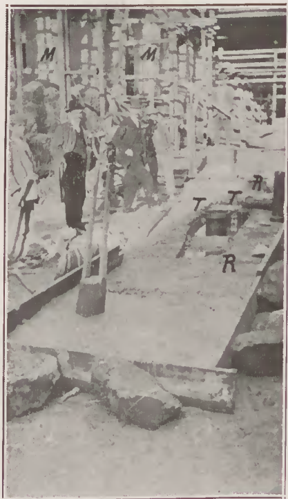
FIG. 12 — RÉSERVOIR RR CONSTRUIT SUR LES SOURCES 7 À 10, APRÈS QUE LA CAGE EN PLANCHES A ÉTÉ ENLEVÉE ET DÉJÀ COUVERT EN PARTIE. — TT — TUYAUX EN GRÉS PAR LESQUELS L'EAU THERMALE SORTIRA APRÈS LE BATTAGE DU RADIER GÉNÉRALE EN BÉTON. — MM — MURS DE L'ÉTABLISSEMENT BALNÉAIRE.
