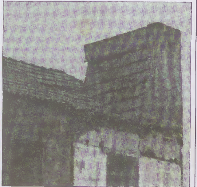
Chaminé da casa agora destruída
