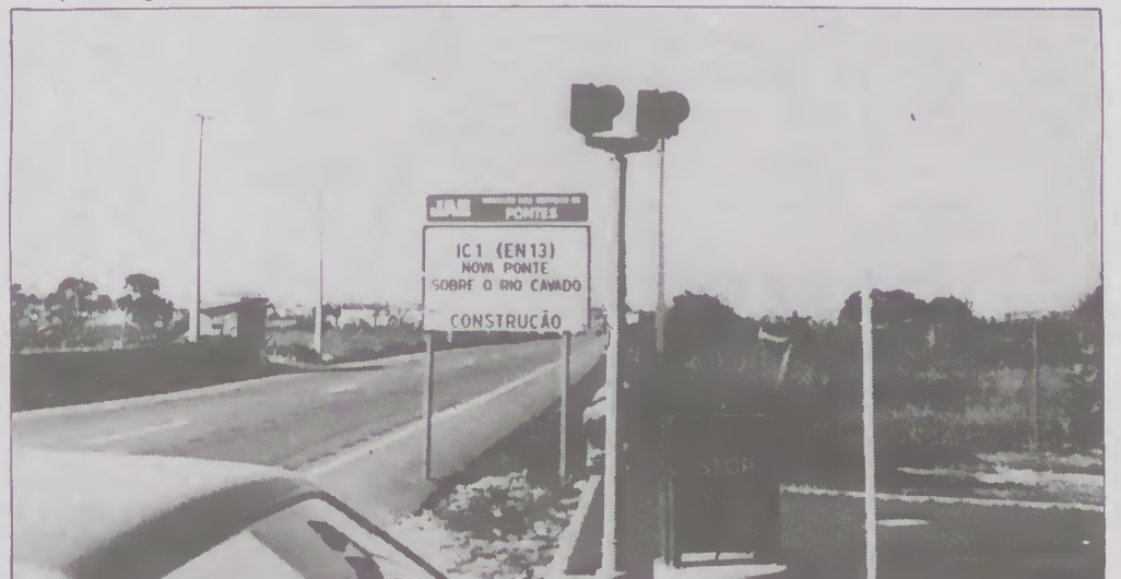
Placa puramente enganosa, porque a ponte se encontra parcialmente construída e as obras estão há muito paradas...
