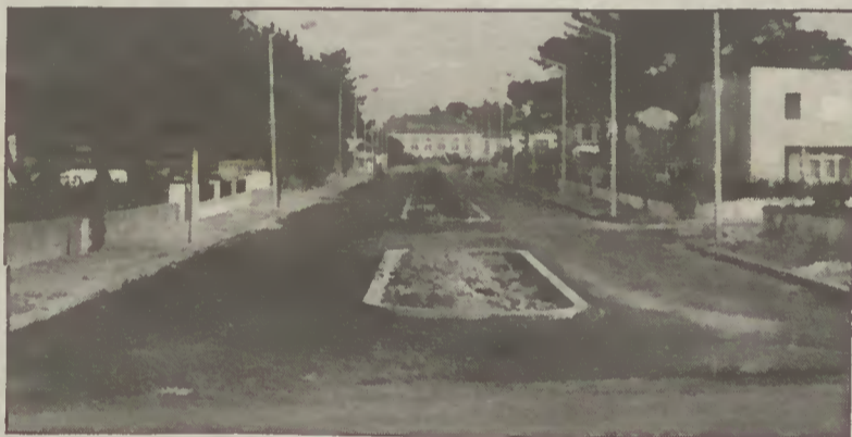
Estado actual das obras de restauro da avenida Rocha Gonçalves com piso alcatroado
